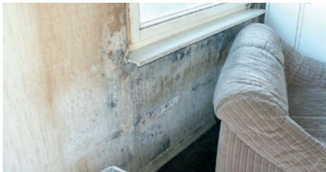
Schimmelbefall auf einer Außenwand hinter einem Sofa
