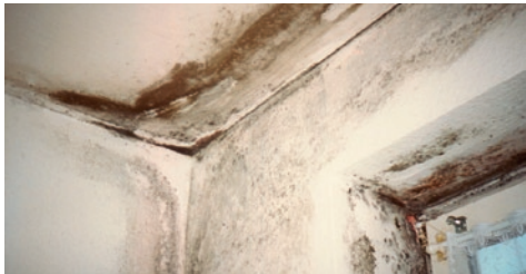
Wärmebrückenbedingter Schimmelbefall in einer Altbauwohnung
