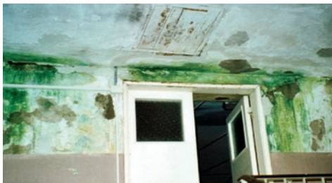
Großflächiger Schimmel- und Algenbefall in einem Treppenhaus
